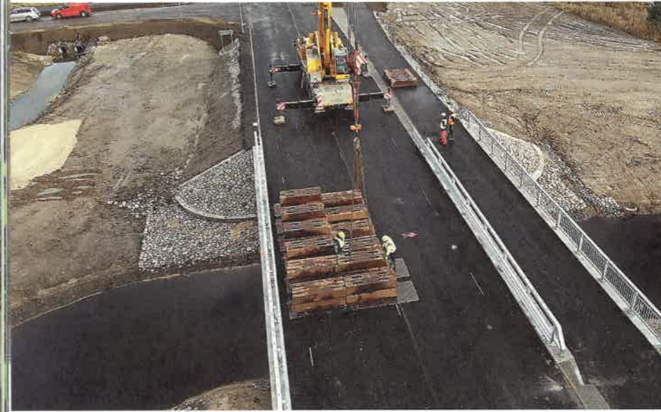
Ehitise seisukorra ja kvaliteedi kontrollimiseks viiakse mõnikord läbi ka proovikoormamisi. Fotol on näha vastvalminud silla proovikoormamist malmplökkidega (kokku 94 tonni), et veenduda nõutavas kandevõimes. Foto: Martti Kiisa
