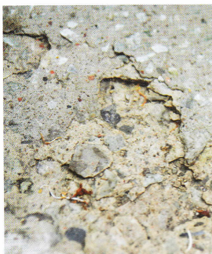
Foto 1. Betooni pind lahtirakestamisest ja kuus kuud hiljem, pärast esimesi külmakahjustusi.
