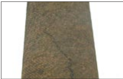
Foto 5. Kaldega pragu korstnaseinas.
