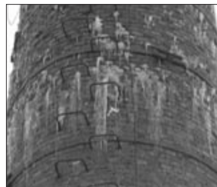
Foto 2. Kondensaadi tungimine läbi korstna seina (kondensaat on jäätunud).
